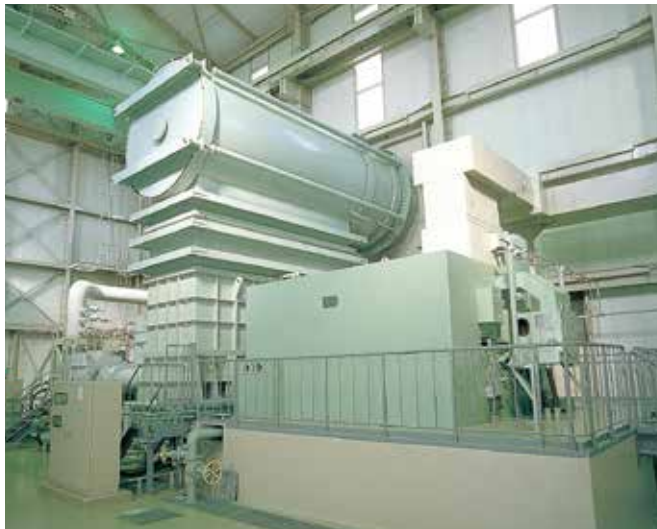
タービン・発電機
