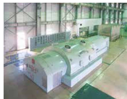
タービン・発電機
