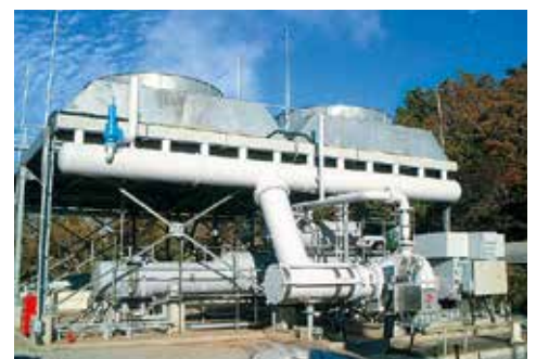
八丁原バイナリー発電所
