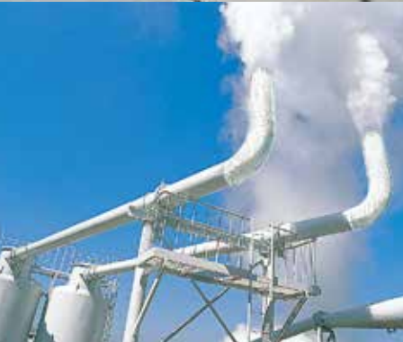
坑口サイレンサー 蒸気タービン停止時などに、生産井から噴出する蒸気を大気へ放出する際の騒音を低減する設備。
